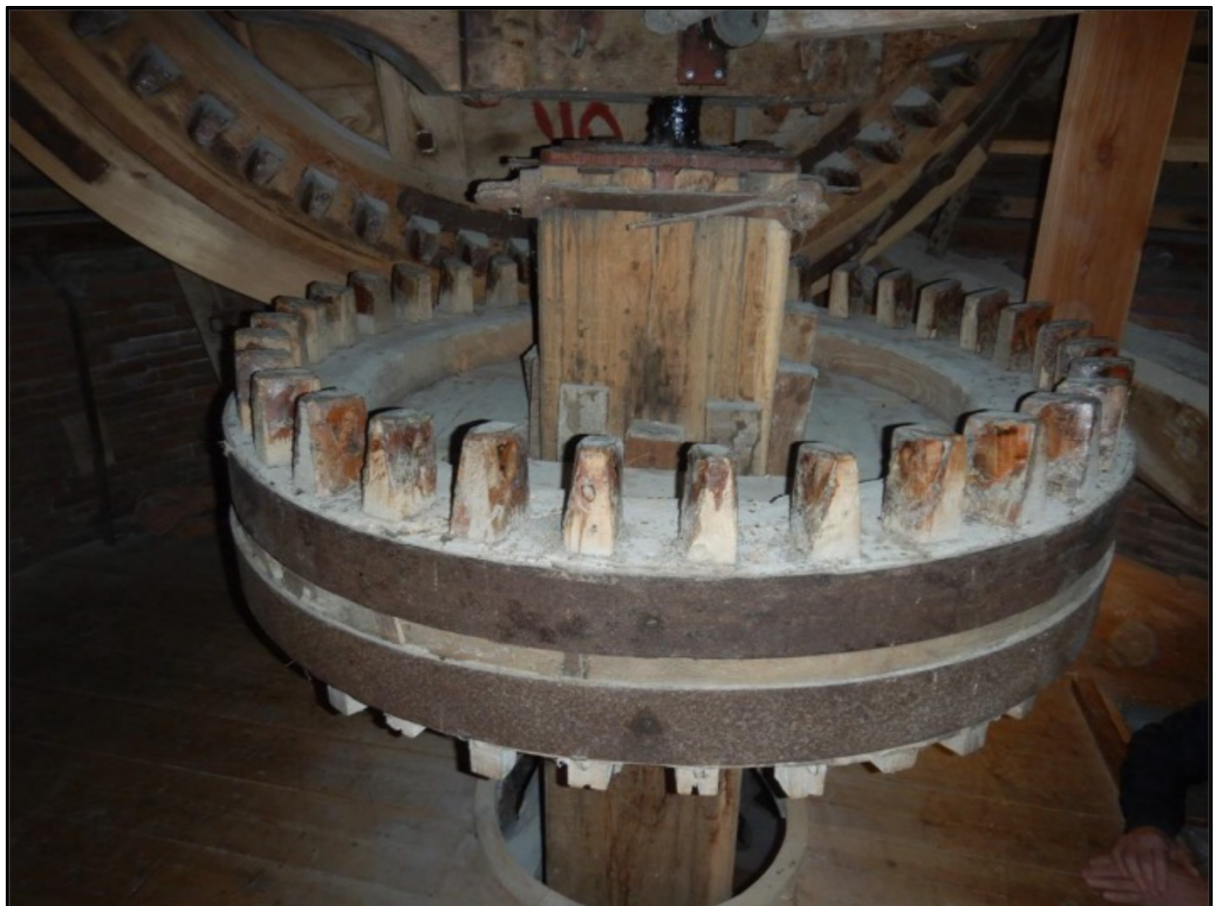
Figuur 1 - De bonkelaar dient vanwege slijtage te worden vervangen.
